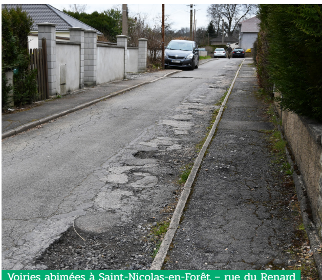
Voiries abimées à Saint-Nicolas-en-Forêt - rue du Renard
