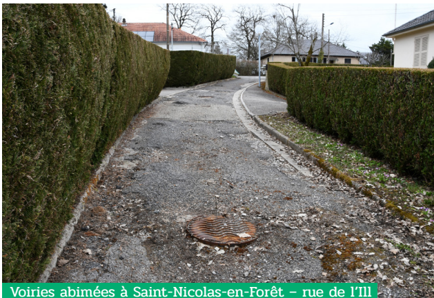
Voiries abimées à Saint-Nicolas-en-Forêt - rue de l'III
